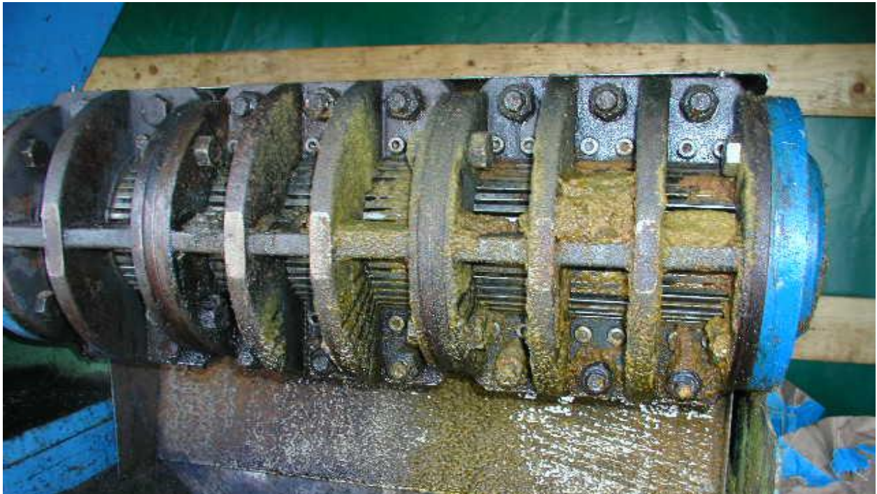
Photo APAD. Cage de machine à barreaux
