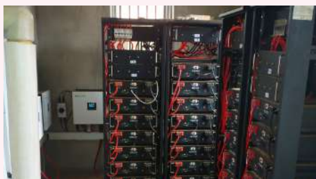
Parc de batteries, autonomie pour faire face à une journée sans aucun apport solaire
