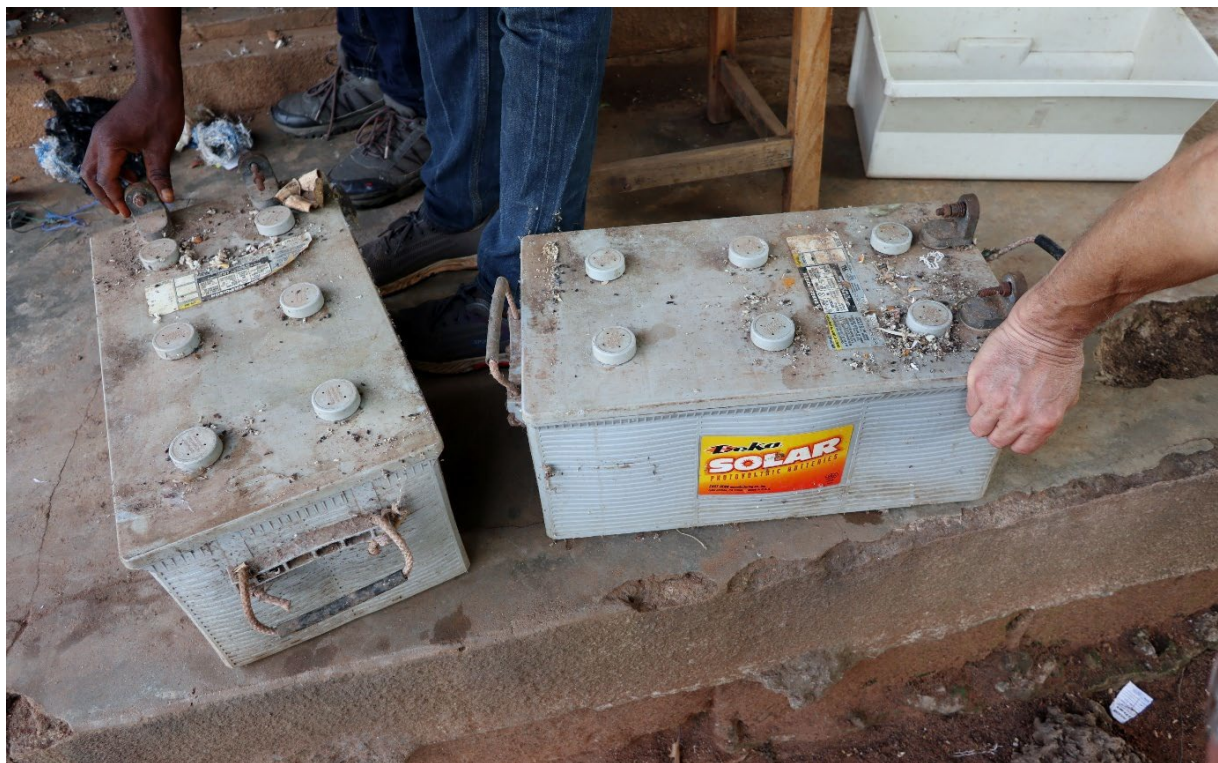
Changement de batteries à Porto Novo avec Songhai, ©Electriciens Sans Frontières, 2022.
